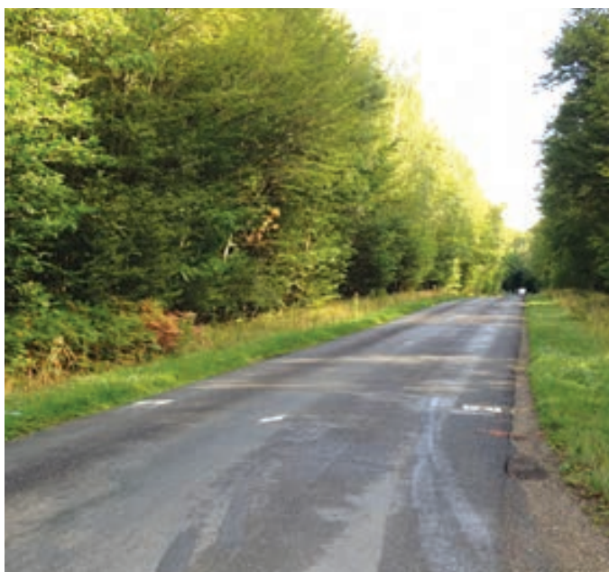
Exemple de manque d'accotement - RD10 - Commune de Jossigny
