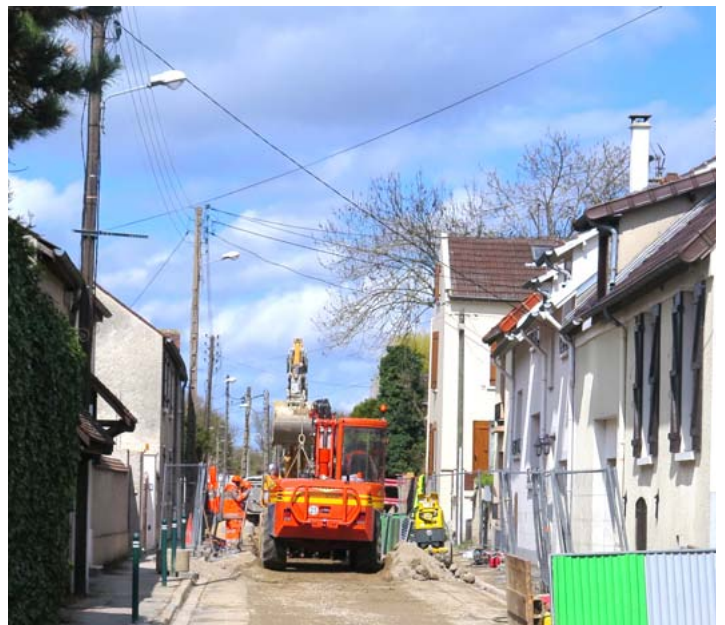
Les centres anciens présentent des réseaux d'assainissement à remettre aux normes. Un important chantier a débuté fin mars à Chalifert pour la mise en séparatif des réseaux dans la rue Charles Vaillant.
