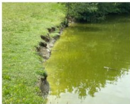
Berge de type 2 – Naturelle avec érosion marquée
