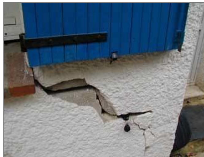
Exemple de dégâts causés par le retrait ou le gonflement des argiles (source : BRGM)
