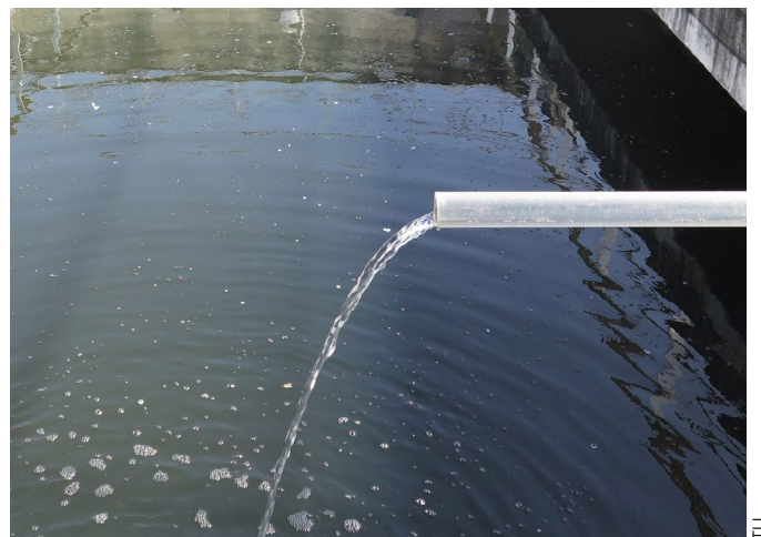
Après la décantation chimique, des bactéries fixées sur micro-billes finalisent l'épuration dans des bassin à l'air libre avant de rendre l'eau clarifiée à la Marne.
