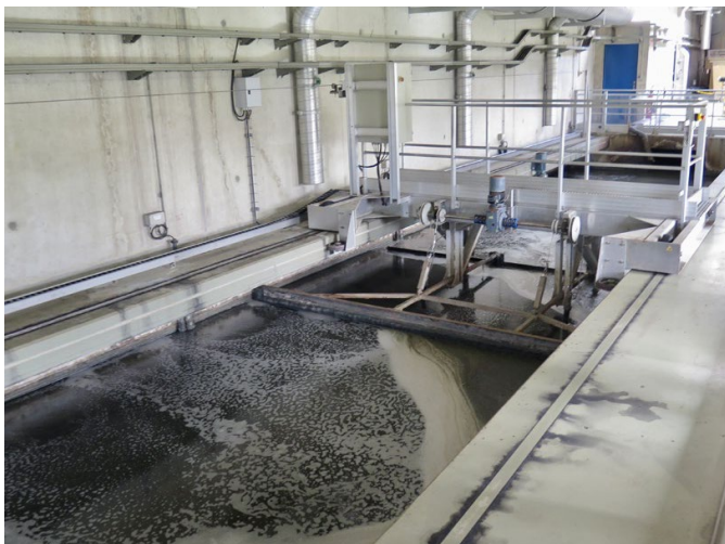
Le déshuilage des eaux usées, première étape de leur épuration
