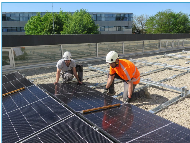
Énergies renouvelables pour les bâtiments de Marne et Gondoire
