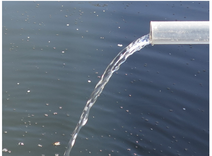
Eau épurée dans un bassin du SIAM
