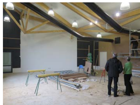
L'intercommunalité a financé les travaux de la partie «musique» de l'extension de la Courée. Ci-dessus, l'auditorium.
